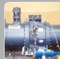
Usine (PL) Puissance calorifique: 233 kW Source de chaleur: l'eau
