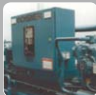
Centre de lavage de voitures (CZ) Puissance calorifique: 140 kW Source de chaleur: l'eau
