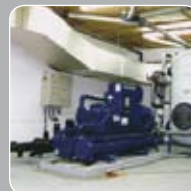
Complexe scolaire Neveklov (CZ) Puissance calorifique: 513 kW Source de chaleur: Sols-terre Source de chaleur: eau glycolée - géothermie
